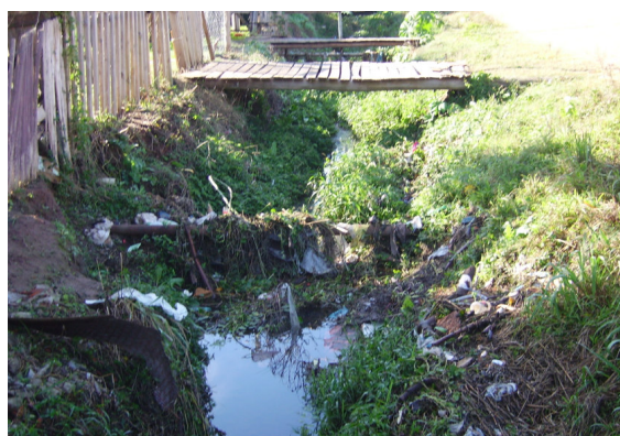
Figura 012 - Km2, vala de escoamento de água servida e pluvial no acesso a edificações.
