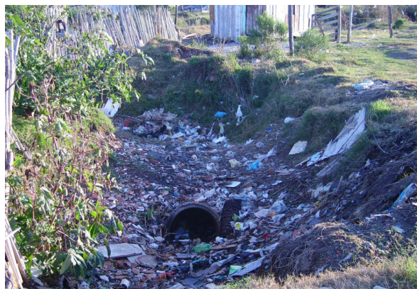
Figura 010 - Km2, vala com acúmulo de lixo no final da rua Olegário Mariano.
