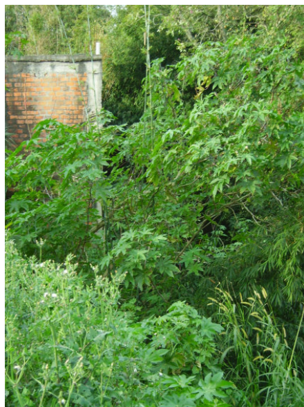
Figura 041 - Vila Nonoai - fundos da edificação 009, proximidade a borda do talude.
