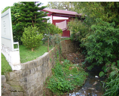
Figura 003 - Vila Cerro Azul, terceiro setor - edificação 042, muro de contenção de talude, assoreamento de canal e lançamento de água servida.
